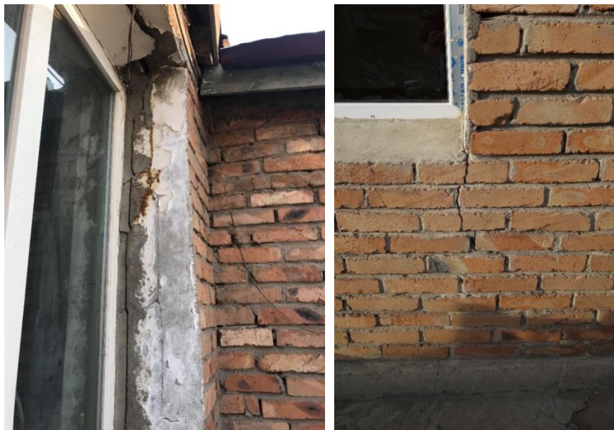
Мод, тоосгоор хольж барьсан байшинд чийг хуримтлагдсаны улмаас хагарал, цууралт үүссэн байдал
